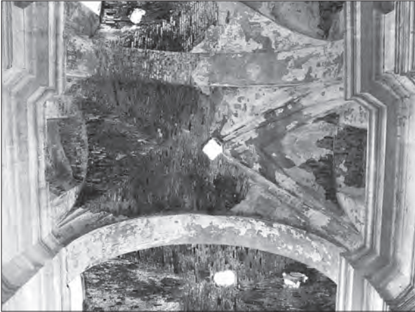
Rys. 7. Tajkury. Kościół parafialny pw. Św. Wawrzyńca. Sklepienie zach. przeszła prezbiterium. Fot. K.Blaschke, 2006.
