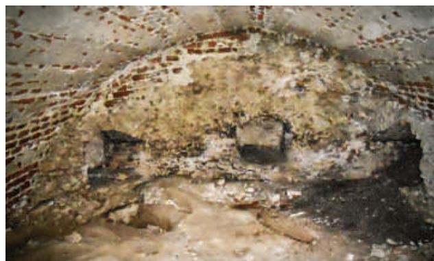
Муровані склепіння під церквою св. архангела Михаїла, с. Мирогоща Перша. Фото: Ю. Пшеничного, 2010 р.
